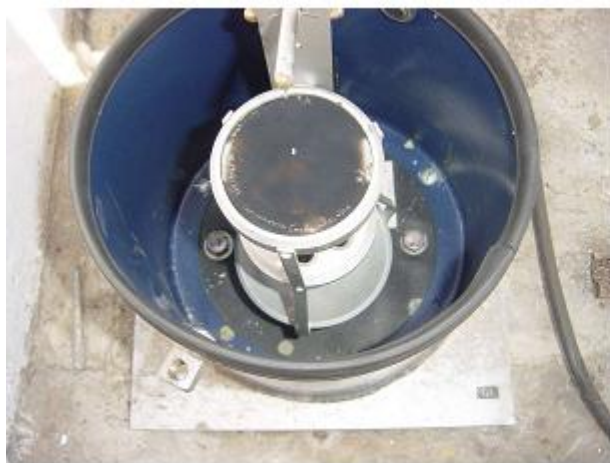
Figura 4.- Casilla 3 – Sismoscopio Serie 204 (Coronamiento Presa – Cota 710)
